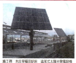
施工例 本庄早稲田駅前 追光式太陽光発電設備
