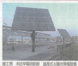
施工例 本庄甲稲田駅前 追光式太陽光発電設備
